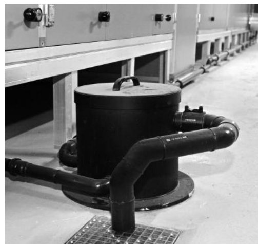
Siphon central pour l'eau de condensation.
