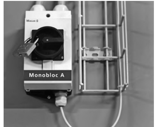
Installation sécurisée par un cadenas personnel.
