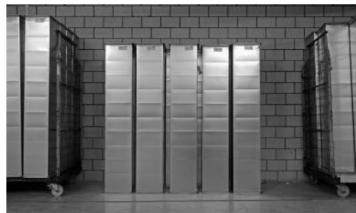
Luftkanäle vor Einbau, geordnet und sauber gelagert.
