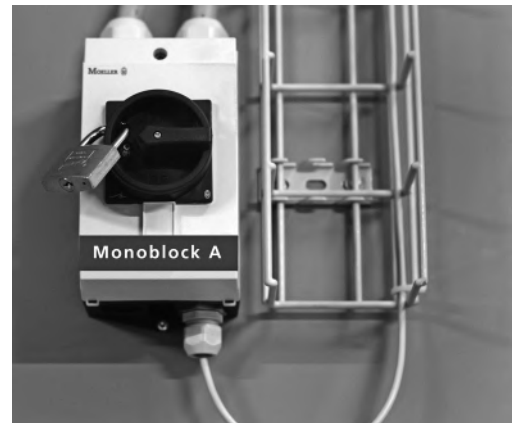
Sicherung der Anlage mit persönlichem Vorhängeschloss.
