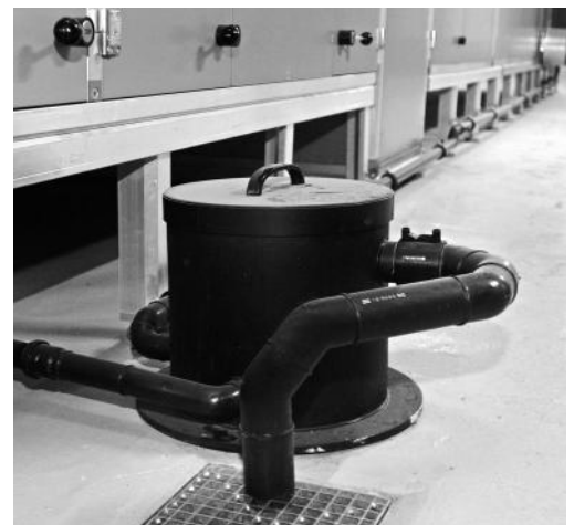
Zentraler Siphon für Kondenswasser.
